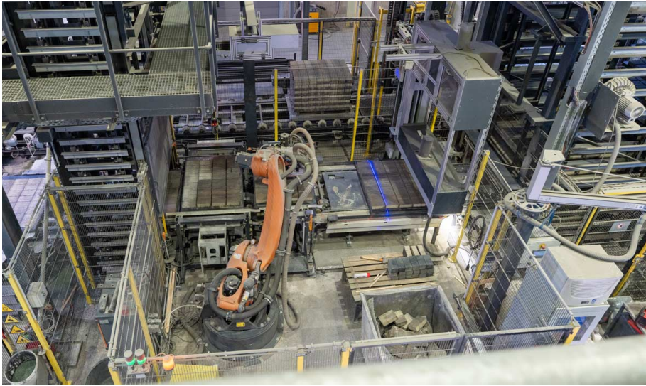
Bild 2 | Die Anlage ermöglicht eine vollautomatische Inline-Qualitätskontrolle, die rund um die Uhr fehlerhafte Steine in Echtzeit aussortiert.
